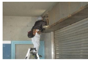
シャッター定期点検
