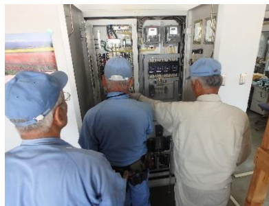
電気設備保守点検
