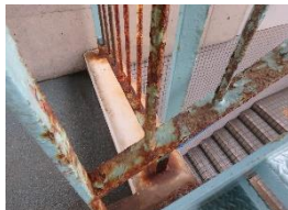
塩害による錆
